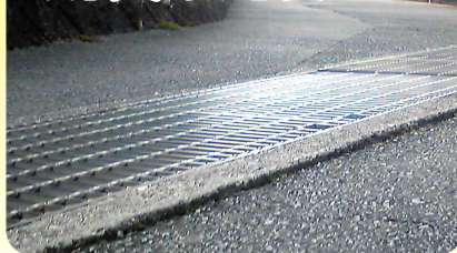
舗装材の沈降による段差
