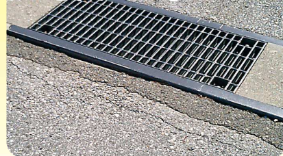
繰り返し補修された後
