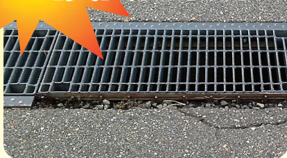
衝撃による破損
